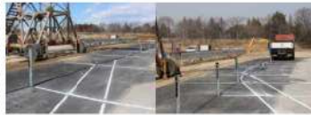
衝突後の防護柵の破損状況(2014年3月)
