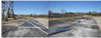
衝突後の防護柵の破損状況(2012年1月)
