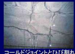
コールドジョイントとひび割れとの組合せでブロック化
