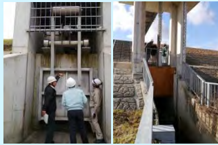
老朽化する水門ゲートの維持管理に関する検討
