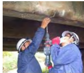
塩害特定点検実施状況
