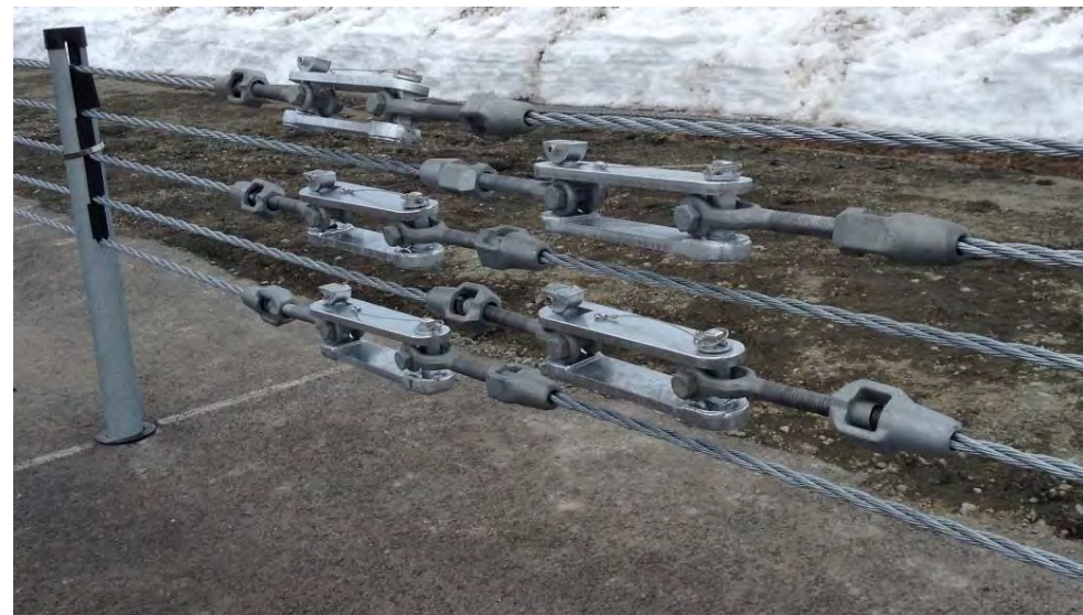
緊急開放金具の設置状況
