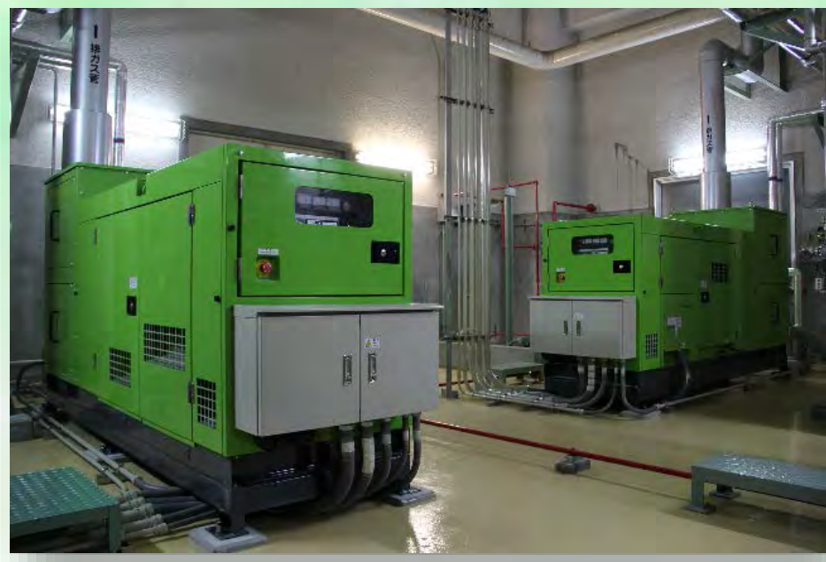
堀之内浄化センター 殿場内
