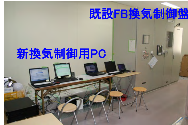
新換気制御の状況【電気室内】
