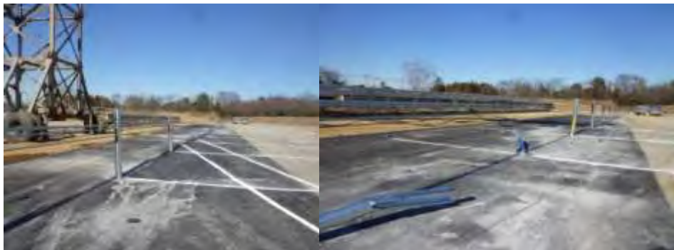
衝突後の防護柵の破損状況(2012年1月)
