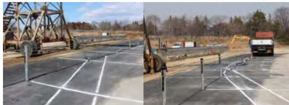
衝突後の防護柵の破損状況(2014年3月)
