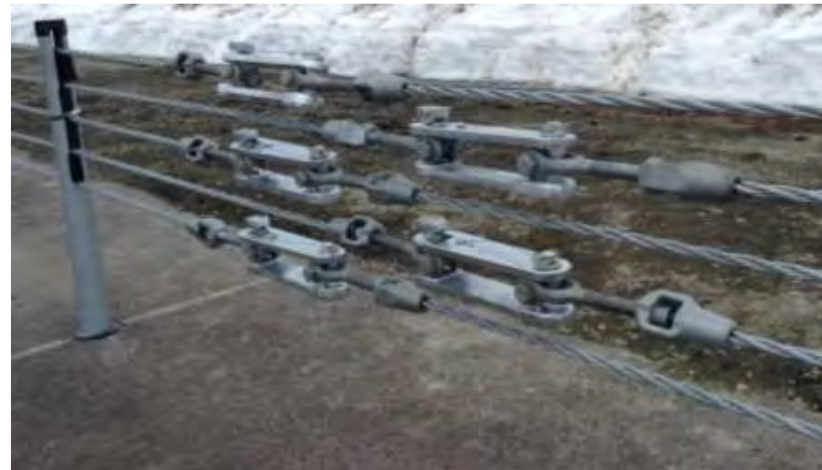
緊急開放金具の設置状況
