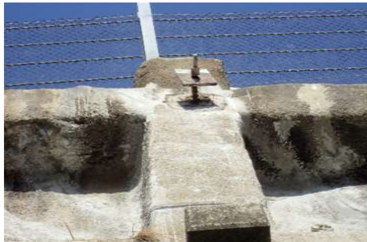
腐食により破断したアンカー
