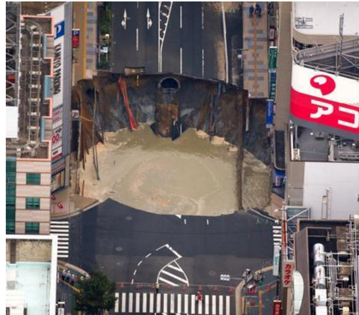
地下鉄トンネル工事 による陥没事故 (2016年)
