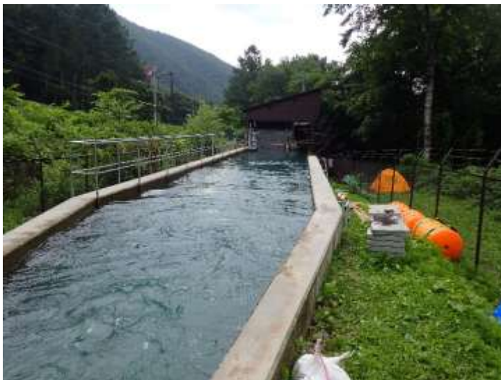
水槽兼沈砂池(運用中)
