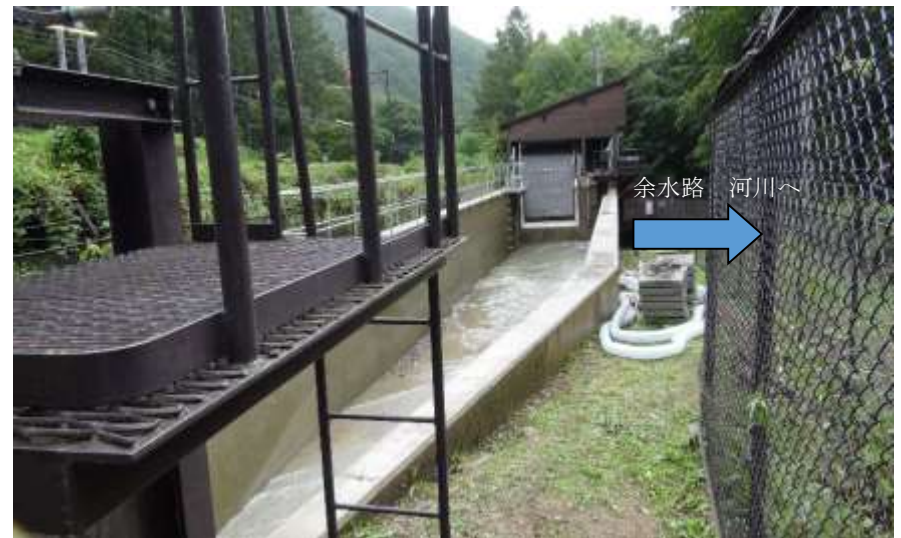
水槽兼沈砂池(排砂時)
