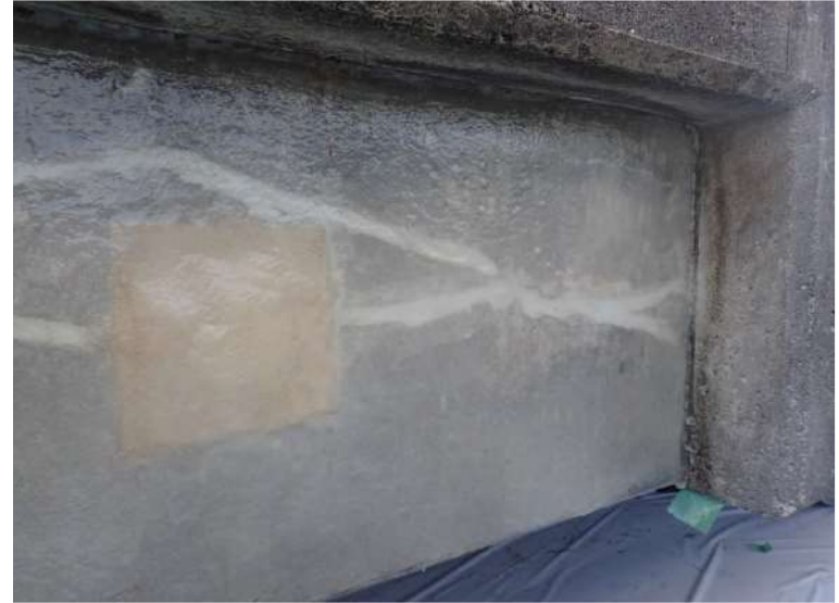
道路橋(補修箇所が多い)
