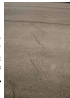
④雁行亀裂
