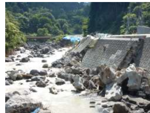
末端部護岸の変状
