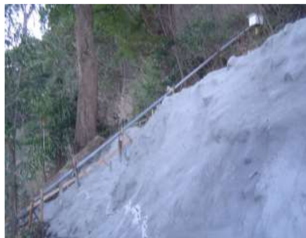
地盤伸縮計による地すべり監視
