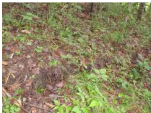
①段差を伴う小規模な開口亀裂
