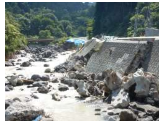
末端部護岸の変状
