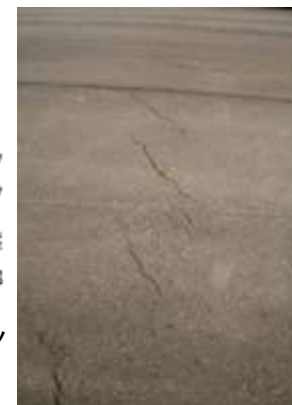
④雁行亀裂
