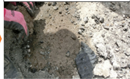
コンクリート床板の土砂化
