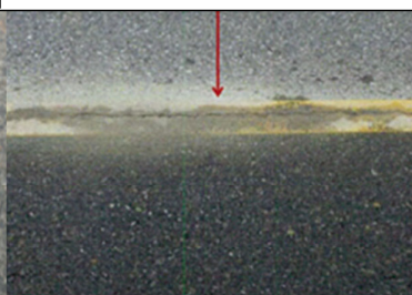
舗装打継ぎ目から浸水
