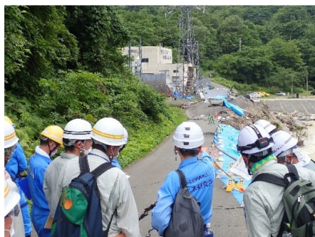
緊急的な現地調査
