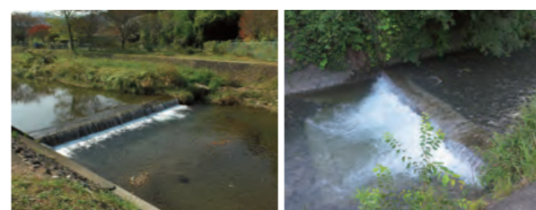
写真1 下流側の河床が低下して落差を生じた帯工
