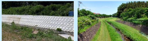
周辺との明度差が大きい護岸
