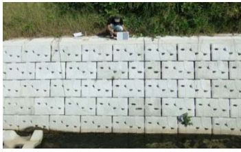
平成 23 年施工 明度 7.0
