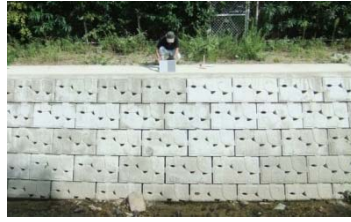
平成 22 年施工 明度 6.5
