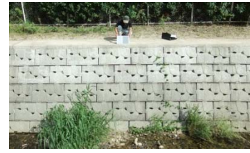
平成 21 年施工 明度 5.0
