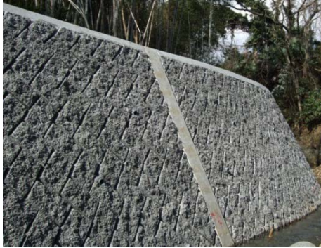
写真-3.18 現場打ちで滑面に仕上げられた 天端コンクリート
