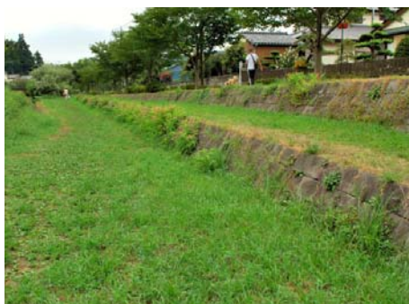
写真-3.23 護岸を階層に分けることにより、一層あたりの面積が小さくなる（まとまりを小さく見せる）。また、水際、天端に植生があり、護岸の見えが小さくなっている
