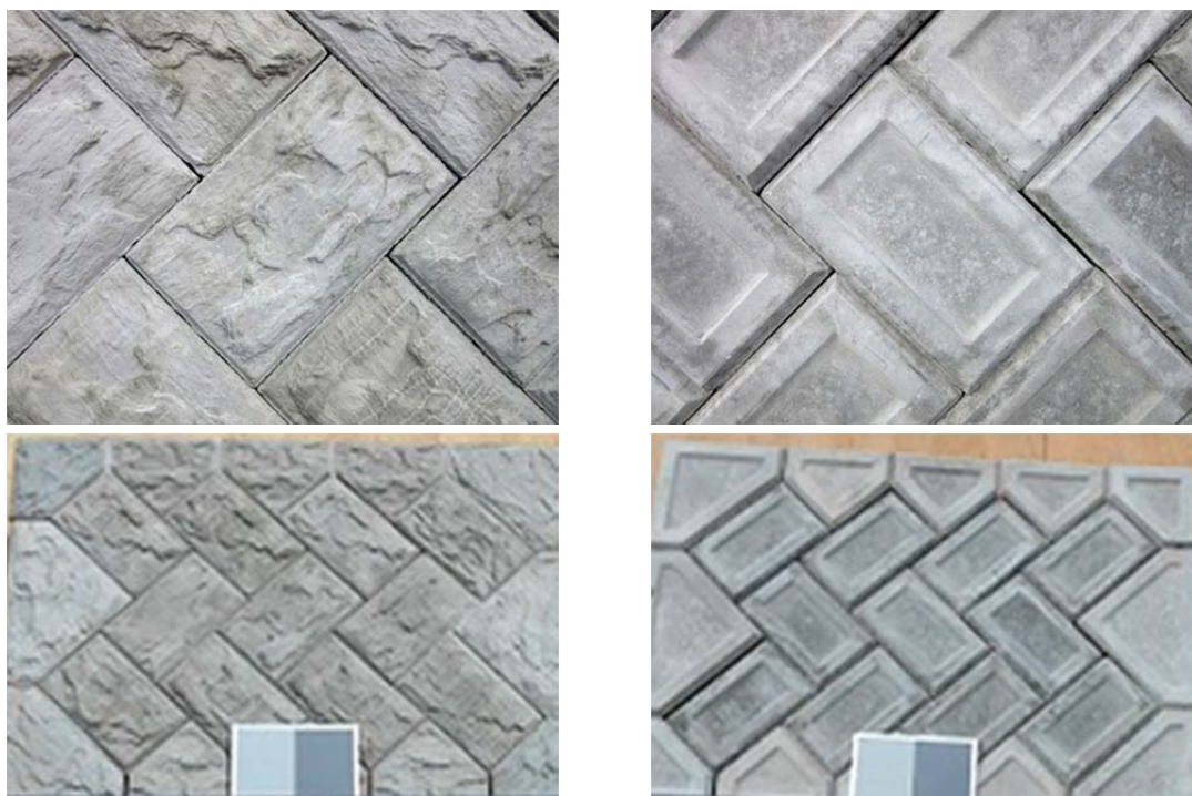
写真-6.35 汚れ、色ムラの例
