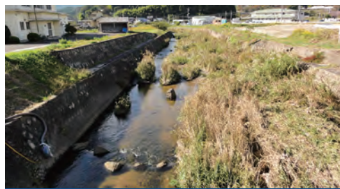
単純な拡幅により、草が繁茂した例
