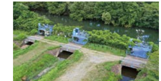
配水池・配水ゲート 新境川の水はこの配水池から制水槽を経由して実験河川・実験池に配水されます。また配水池のゲートを倒すことによって、各河川に約4m 3 /sの人工的な出水を起こすことができます。
