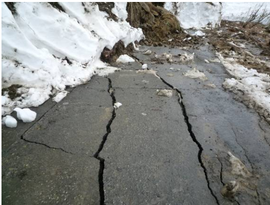
写真-27 道路の亀裂
