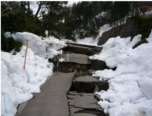
写真-17 道路の破壊
