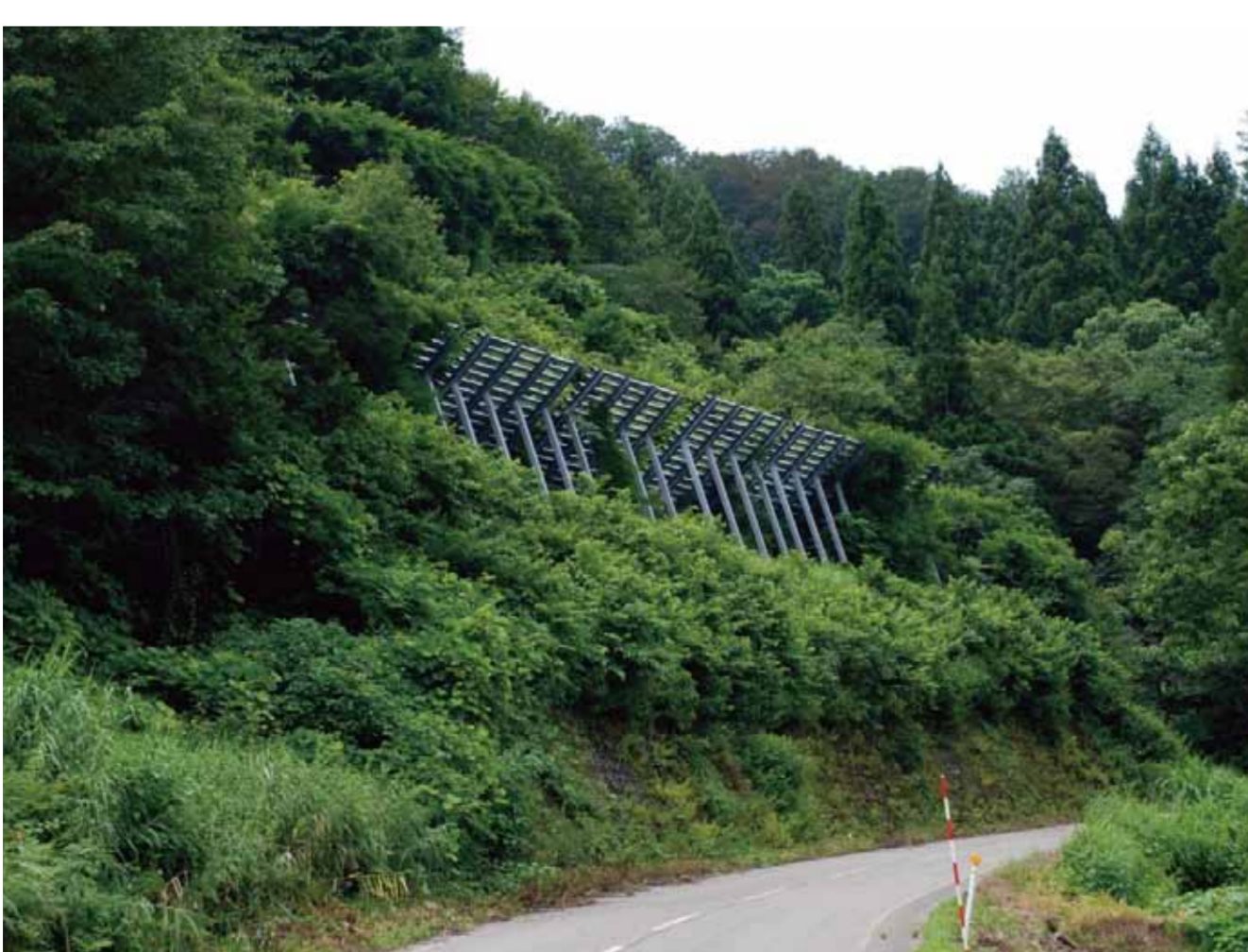
▲ 雪崩予防柵 (新潟県柏崎市) Avalanche fences (Kashiwazaki City, Niigata Pref.)
