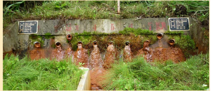
▲写真-1 閉塞した横ボーリング集水管 (新潟県 戸沢地すべり)
