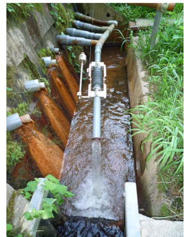
▲写真-5 集水管閉塞防止器の動作状況
