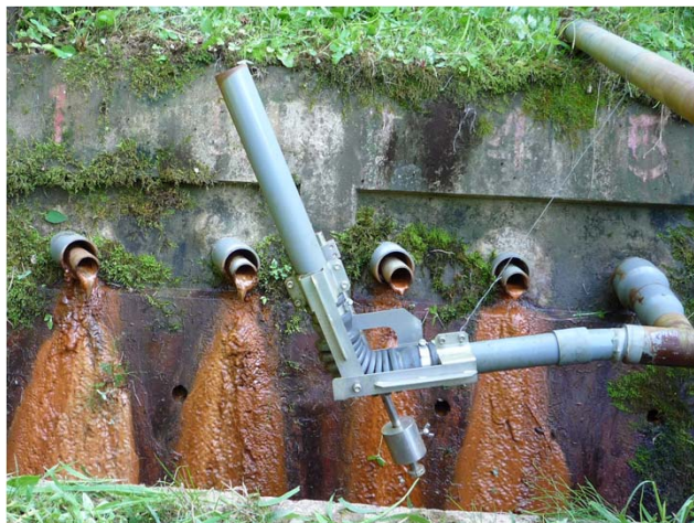
▲写真-3 集水管の閉塞物除去後135日の閉塞物付着状況
