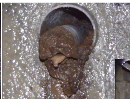
▲写真-4 集水管の閉塞状況
