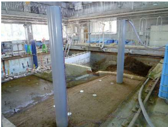
(a) フロートレス水位制御装置設置状況
