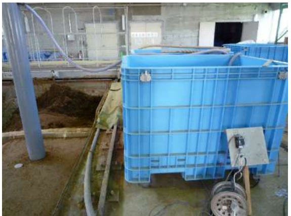
(b) 装置と電源接続状況
