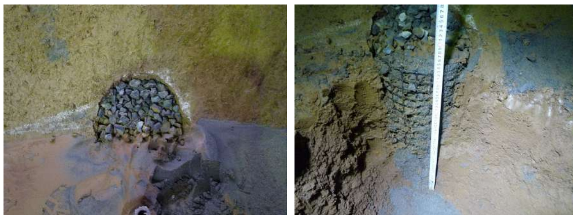
(a) 実験後のドレーン
