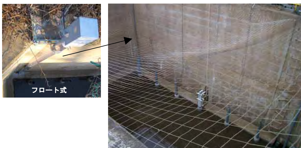
写真2-3 水位計の設置状況
