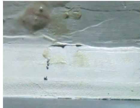
(d) 変状箇所の平面写真
