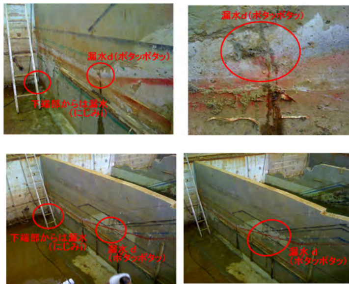
図-A.6 ピットC側での漏水状況写真
