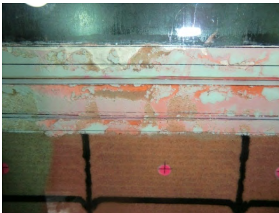
(e) 変状箇所の横断面形状
