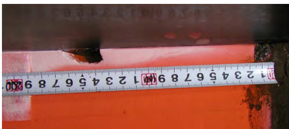
(g) 変状箇所の平面形状（掘削）
