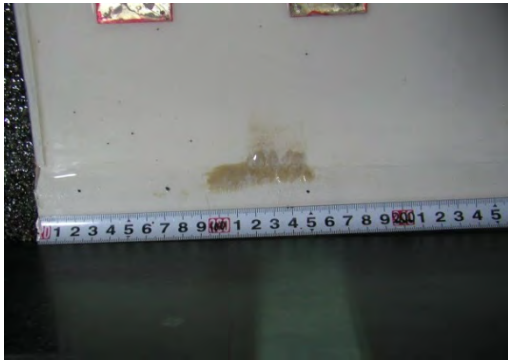
(c) 変状箇所の拡大写真
