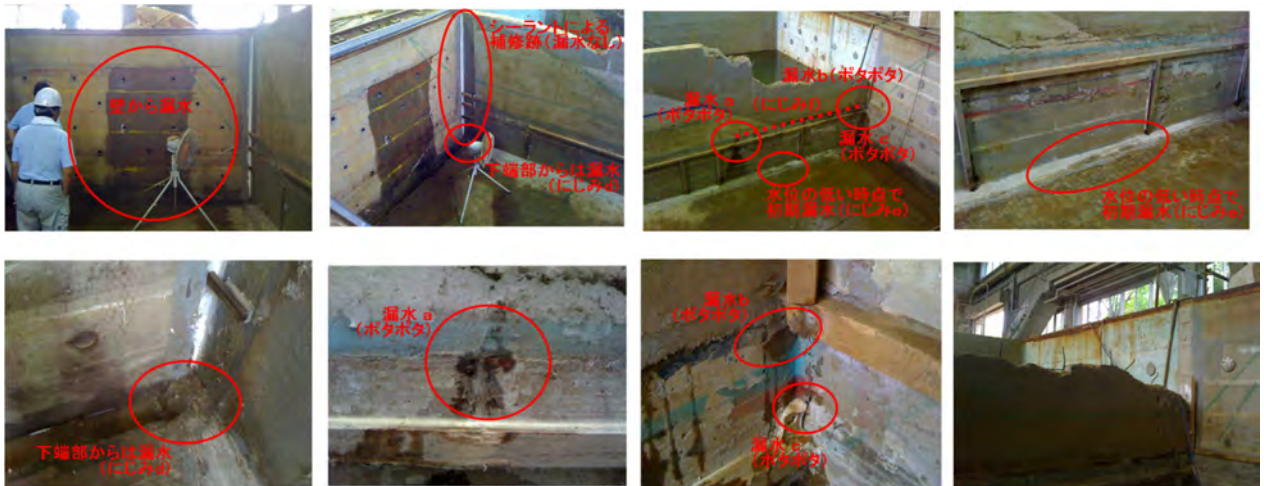
図-A.3 ピットA側での漏水状況写真
