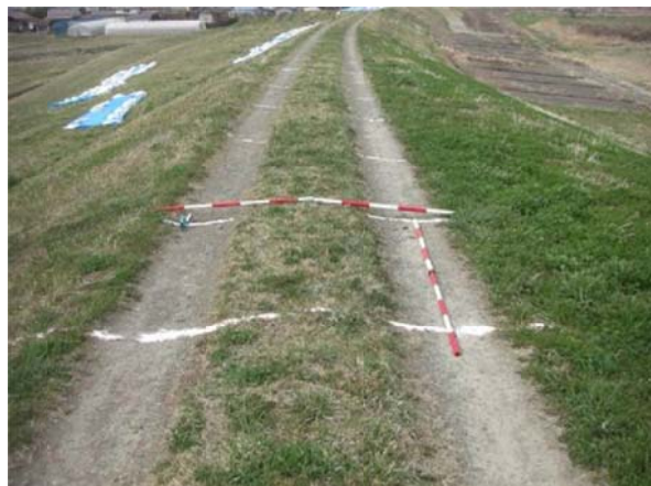
写真-10.2 対策・無対策区間の境界付近に発生した横断亀裂(手前が対策区間。横に伸びる複数の白線が亀裂) 2)
