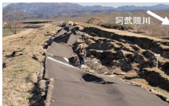
図 2.3.2 堤体の液状化（2011年東北地方太平洋沖地震・阿武隈川） 9)
