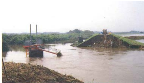
図 2.4.1 樋管周辺での決壊（1986 年台風 10 号，小貝川） 11)
