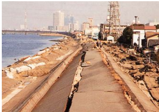
図 2.3.1 基礎地盤の液状化（1995年兵庫県南部地震・淀川） 8)
