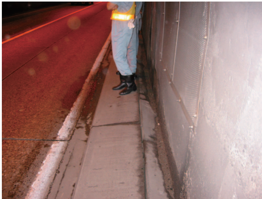
写真 2.4.1 国道8号米山トンネルの監査歩廊の傾斜
