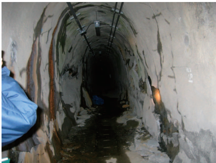
写真 2.3.7 羽黒歩道トンネルにおける地震後の状況
