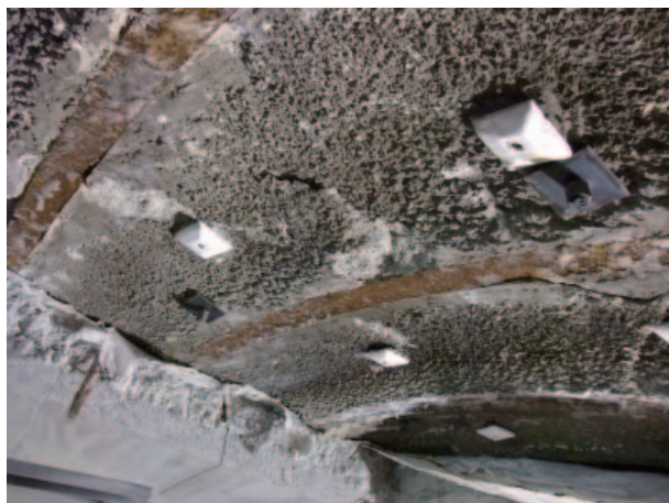
(a) 天端部吹付けコンクリートの圧縮破壊
