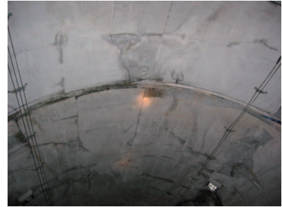
(c) 天端のせん断ひび割れ
