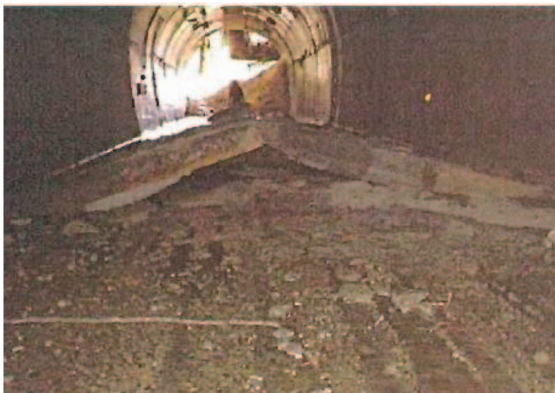
写真 2.3.6 羽黒トンネルにおける路盤の隆起
