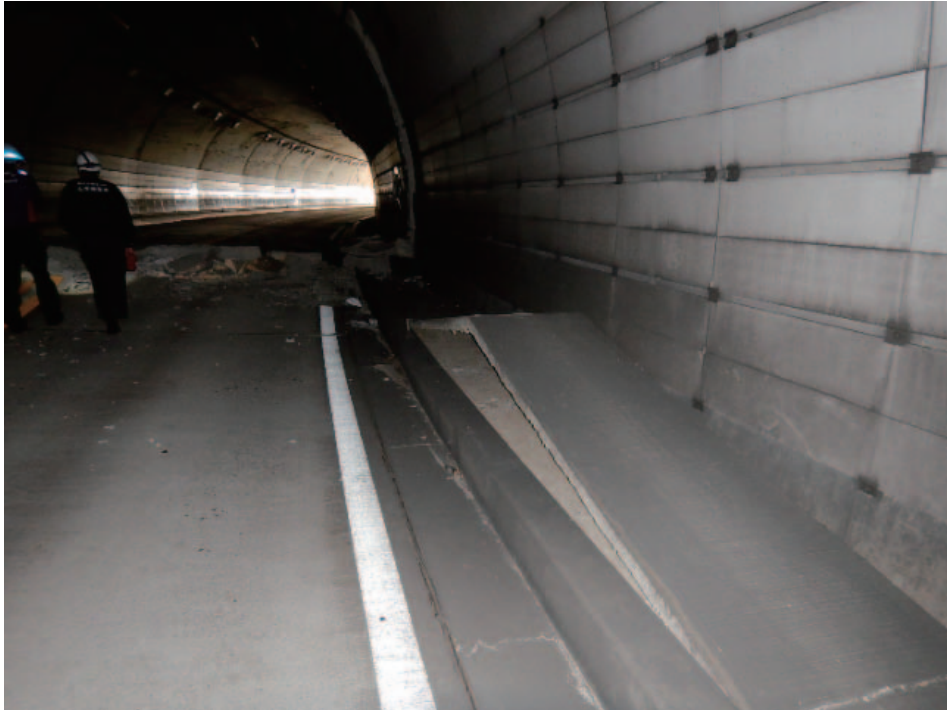
写真 3.2.9 俵山トンネルのスパン 12～13 付近の監査歩廊の浮きあがり状況
