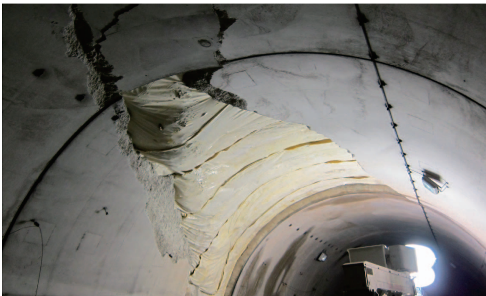
写真 3.2.1 俵山トンネルのスパン 167 付近の状況(縦断方向)
