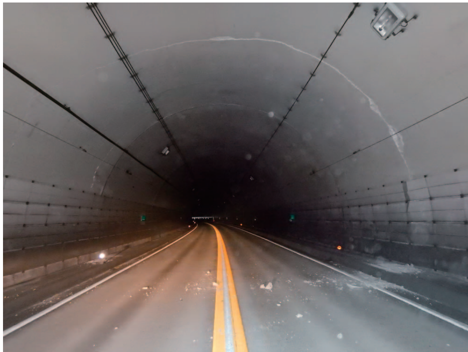
写真 3.3.1 南阿蘇トンネルのスパン 40 付近の写真
