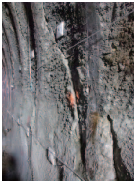
(b) 側壁部吹付けコンクリートのせん断ひび割れ
