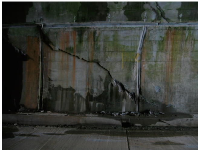
写真 2.3.5 荒谷トンネルにおける斜めひび割れ
