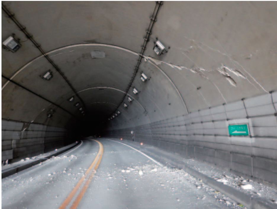
写真 3.2.10 俵山トンネルのスパン4～5付近の状況
