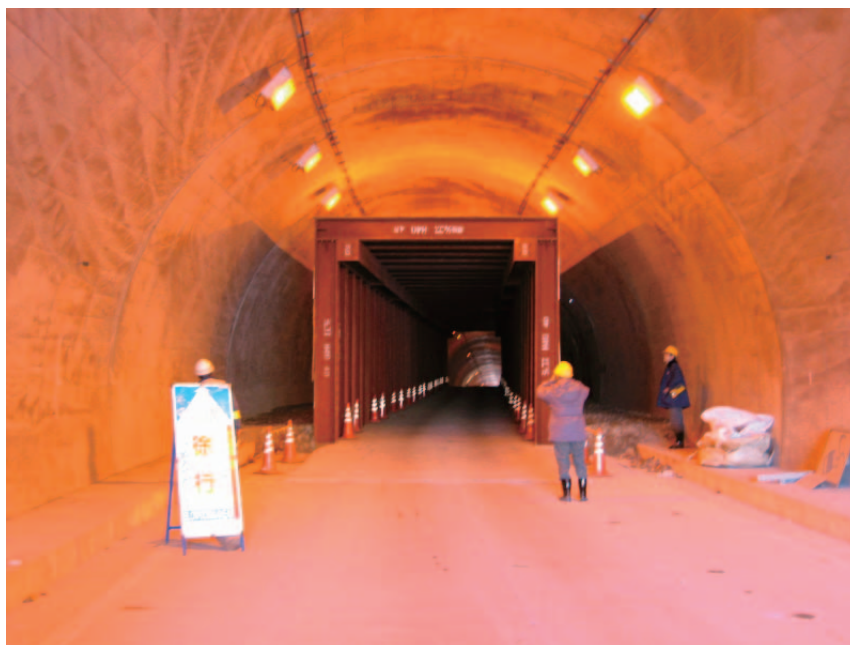
写真 2.3.2 木沢トンネルにおけるプロテクター
