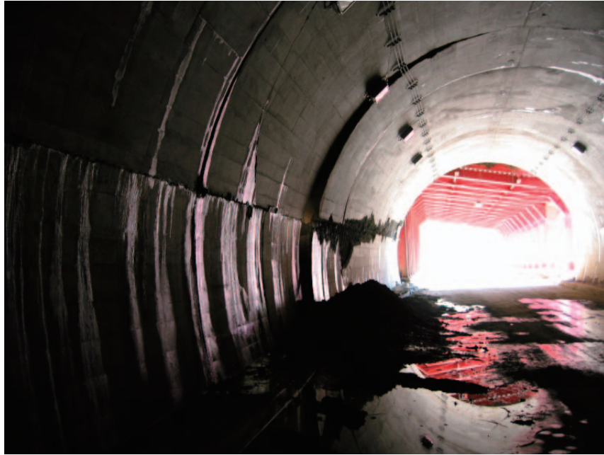
写真 2.3.8 十二平トンネルの変状状況
