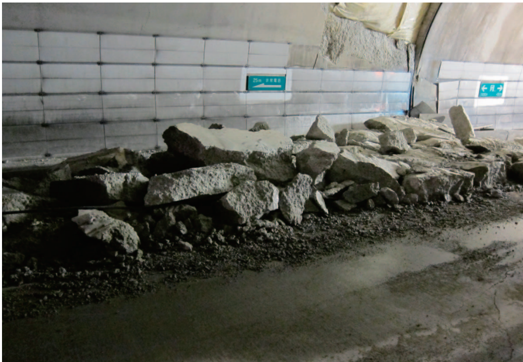
写真 3.2.3 俵山トンネルのスパン 167 付近の状況 (崩落した覆エコンクリート塊を復旧工事のために路肩に寄せた状況)
