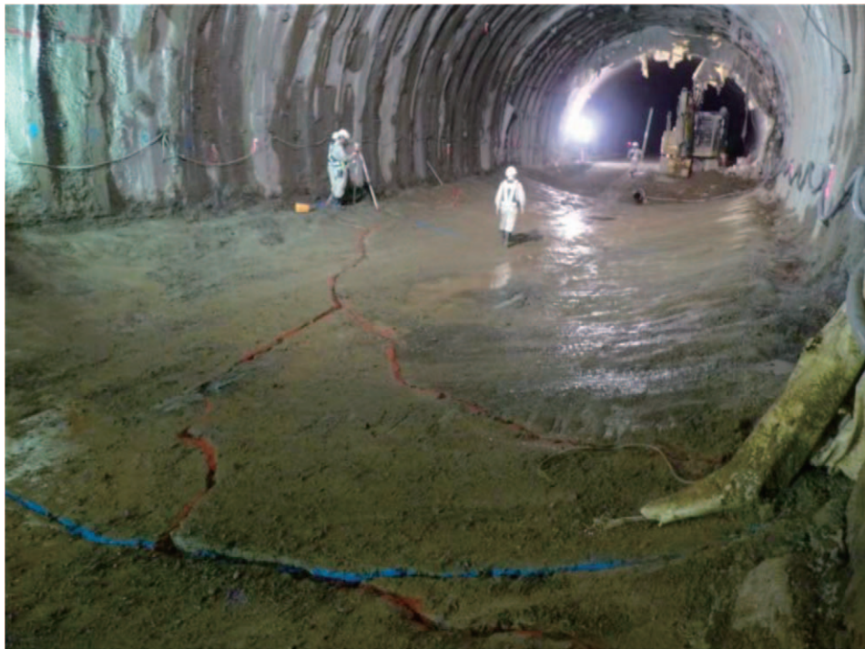
写真 3.2.6 俵山トンネルのスパン 167 付近のインバートの状況
