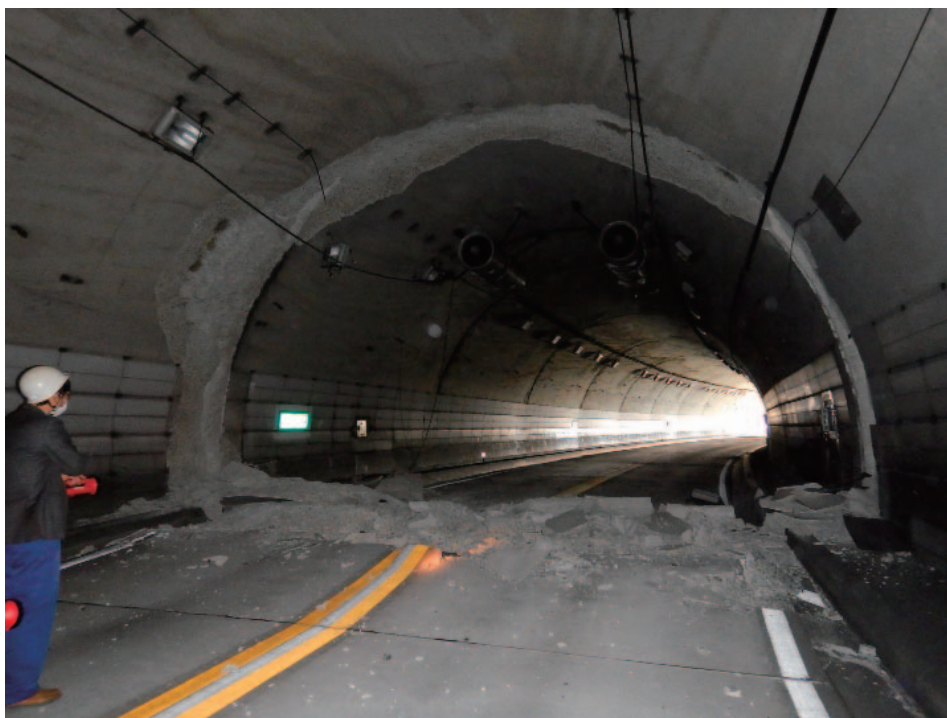
写真 3.2.7 俵山トンネルのスパン 12～13 付近の状況
