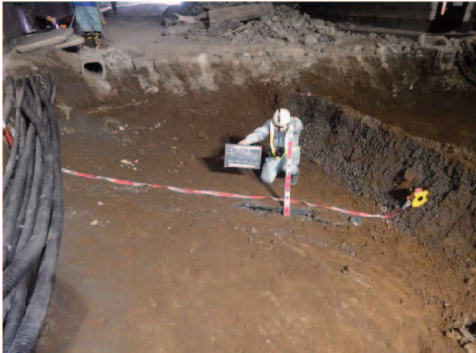
写真 3.2.8 俵山トンネルのスパン 12~13 のインバートの状況
