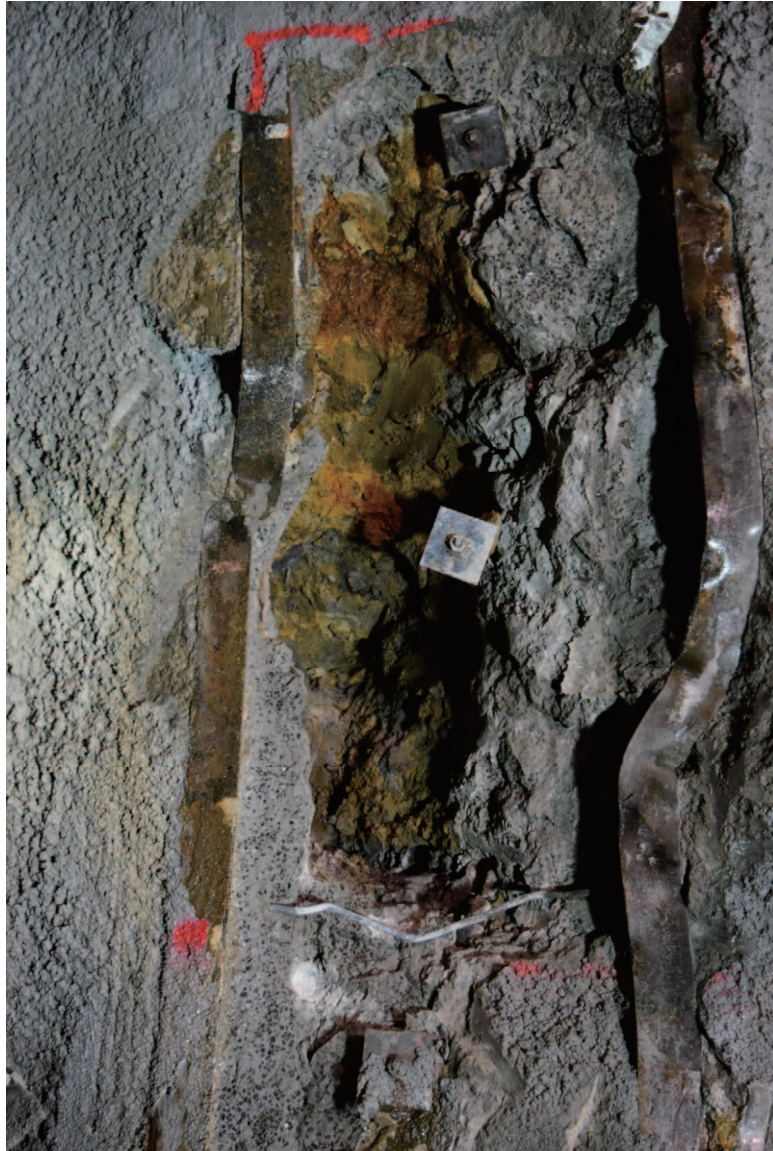
写真 3.2.5 俵山トンネルのспан 167 付近の支保工背面の地山の状況（周辺を吹付けコンクリートで補強した後に既存の吹付けコンクリートを一部撤去）
