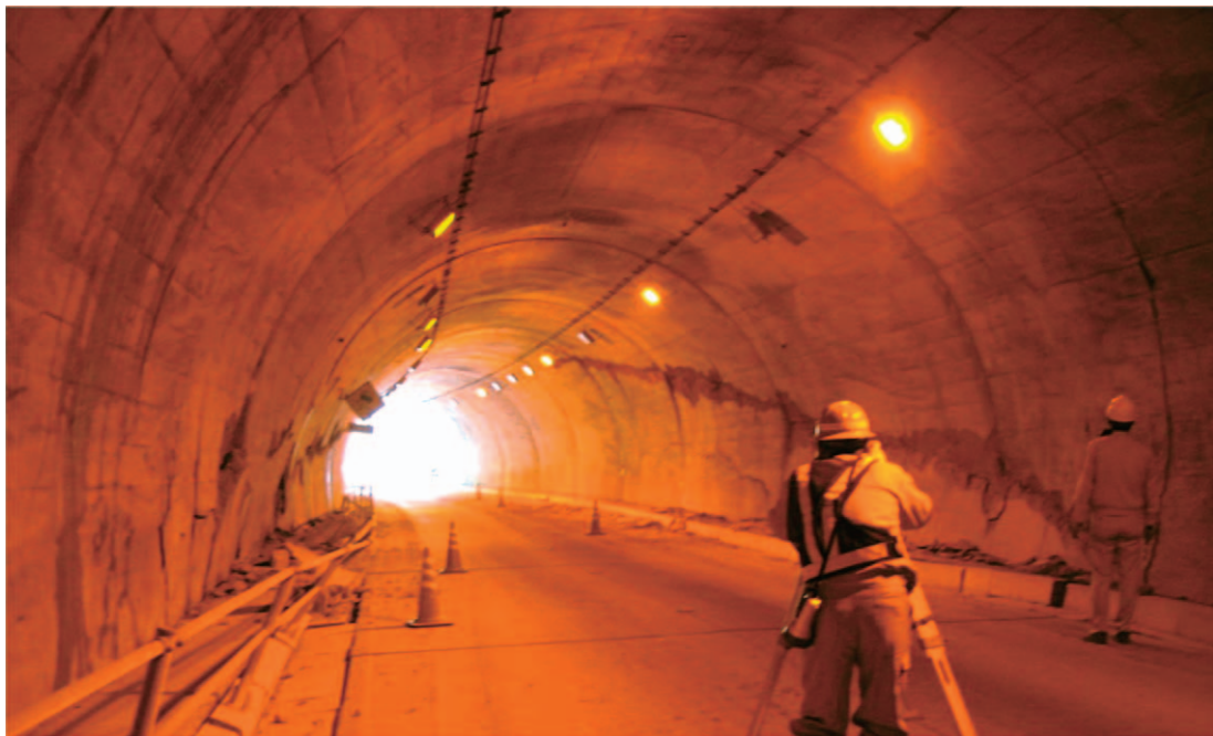
写真 2.3.1 木沢トンネルの変状 (起点側坑口から 30~80 m)
