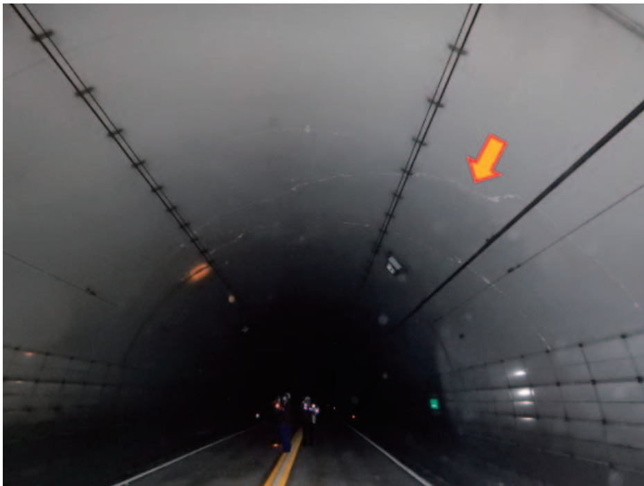
写真 3.2.13 俵山トンネルにおけるアーチ部の斜めひび割れの例（スパン 185 付近）
