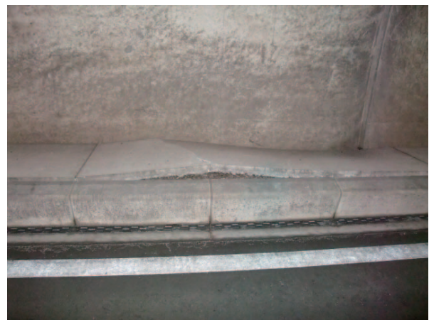
写真 2.5.2 新玉山トンネルの歩道の浮き上がり
