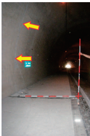
写真 2.5.1 新玉山トンネル覆工の輪切り状のひび割れ
