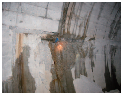
(b) 側壁のはく落
