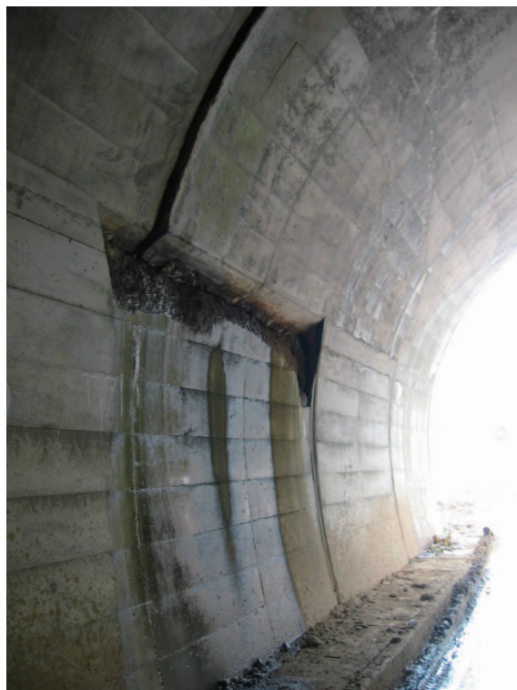
写真 2.3.3 荒谷トンネルにおける打継目の圧縮破壊
