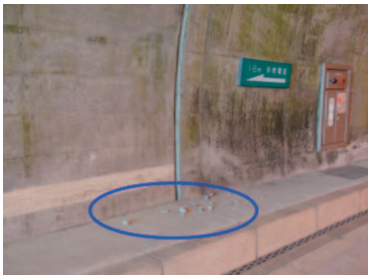
写真 2.6.1 石巻市内の道路トンネルにおける地震後の状況
