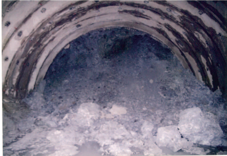
写真 3.3.2 No.260+18 付近の崩落発生状況
