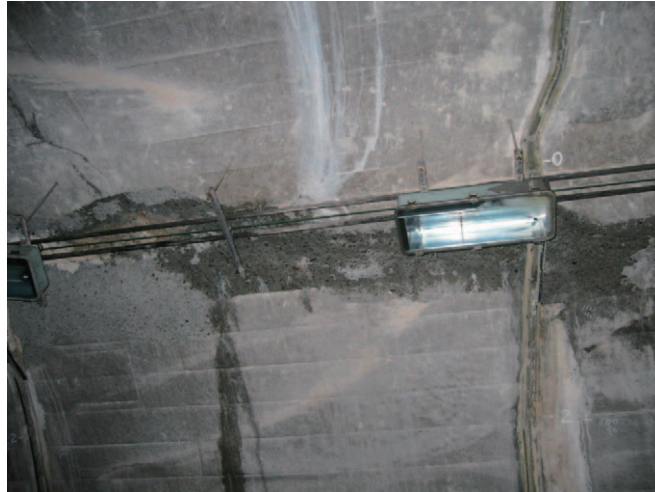
写真 2.3.4 荒谷トンネルにおける天端部の圧ざ（電線管が天端の位置）
