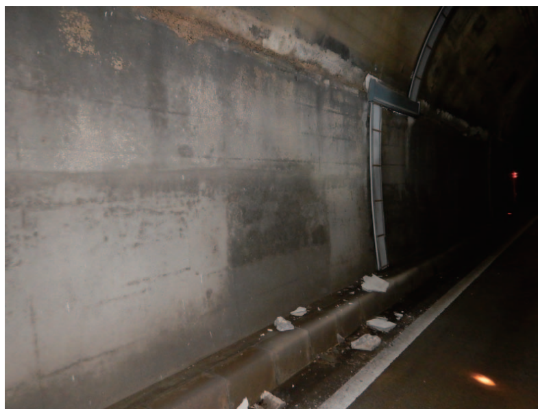
写真 3.4.2 火の山トンネルにおけるモルタル片のはく落
