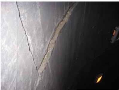
横断目地の段差
