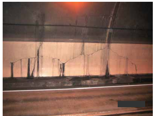
写真-3.11 水圧によるひび割れ
