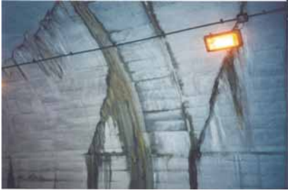
覆工のひび割れ
