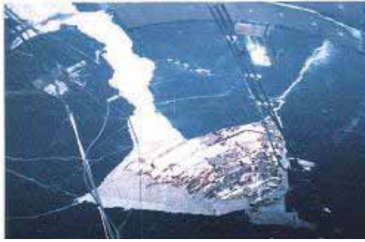
(a) 天端部のせん断破壊
