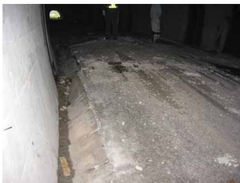
写真-3.9 膨張性土圧による盤ぶくれ
