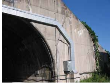
坑門のひび割れ
