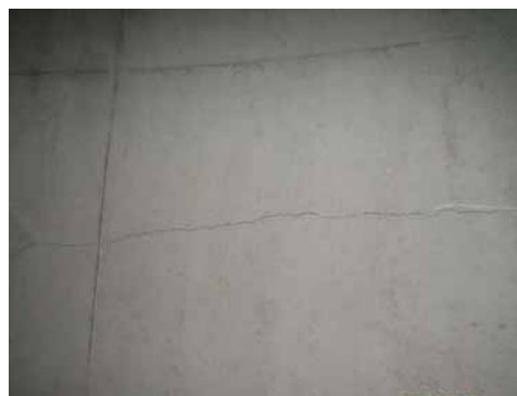
写真-3.13 温度応力・乾燥収縮によるひび割れ
