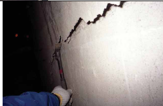
側壁に延びるせん断ひびわれ
