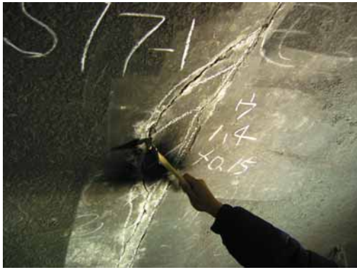
写真-3.14 型枠押し上げによるひび割れ
