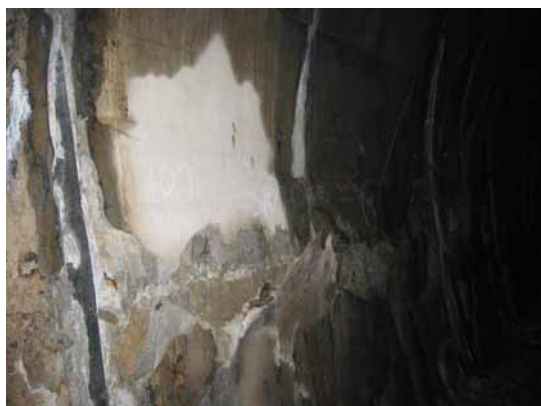
写真-3.19 凍結と融解による覆工のはく離
