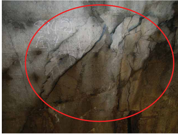
写真2：せん断ひび割れが複数発生し、覆工コンクリートが、分割され、ブロック化して崩落する直前の状態
