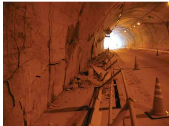
(f) 側壁部のせん断破壊
