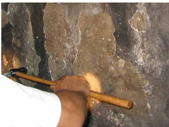
写真-3.20 風化・老化が進行した覆工の例
