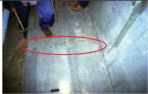
写真2：監査歩廊に連続するひび割れ
