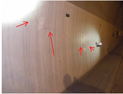
※矢印位置にひび割れが連続する
