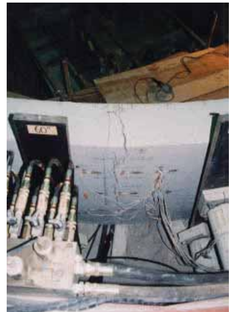
写真-3.4 ひび割れの進展の状況
