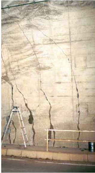
(g) 横断方向のひび割れ
