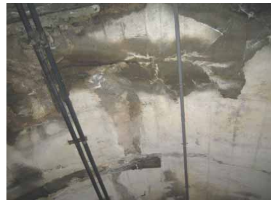
写真-3.23 天端の圧ざの事例
