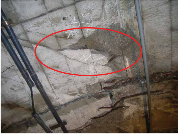
写真1：せん断ひび割れ沿いの一部の覆工コンクリートは落下し、残存する部分もブロック化している
