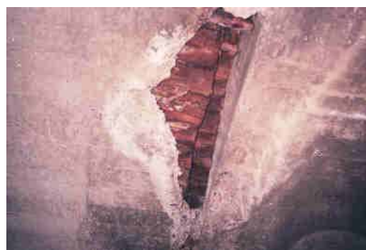
写真-3.17 断面の欠損
