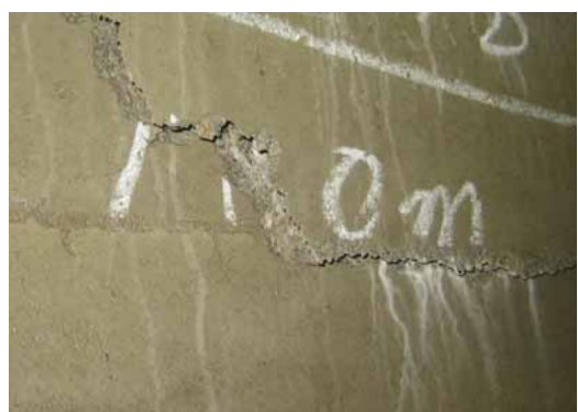
写真-3.24 せん断破壊の事例
