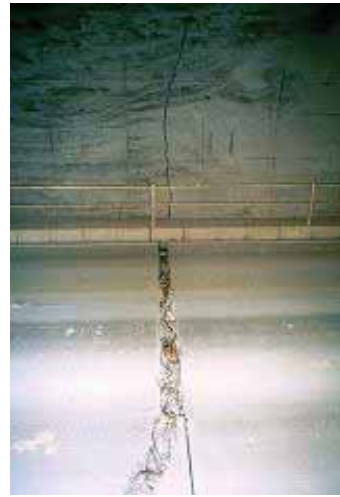
(h) 路面のひび割れ
