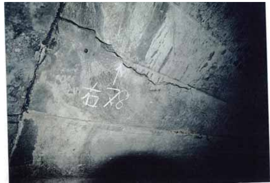
写真-3.22 肩部の開口ひび割れの事例
