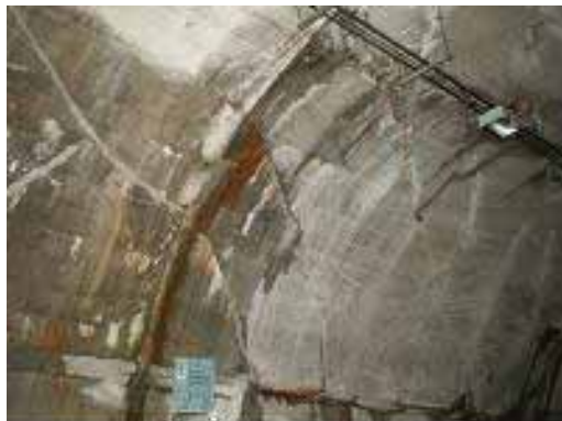
(c) 斜め方向ひび割れ
