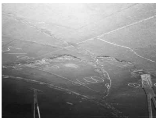
写真-3.7 膨張性土圧によるせん断破壊
