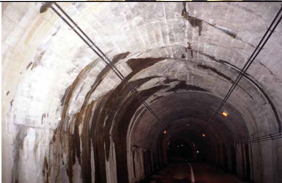
山側（写真左側）にせん断ひびわれが発生
