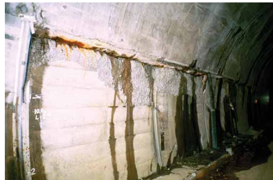
(d) 水平打継目部のせん断破壊
